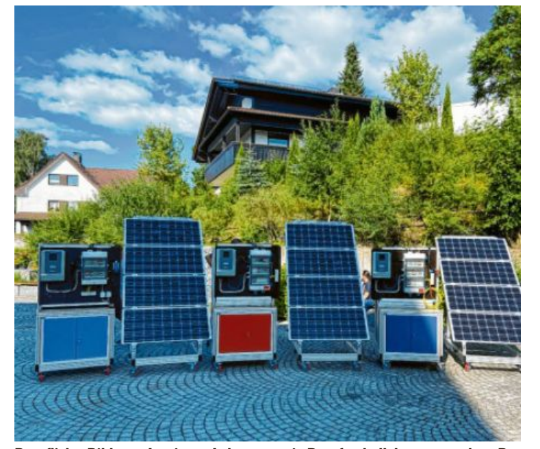
Berufliche Bildung: In einem Lehrgang mit Berufsschullehrern aus dem Bereich der Metall- und Elektrotechnik entstand eine voll funktionstüchtige PV-Anlage mit Speicherfunktion für eine (autarke) 3-phase Hausversorgung.
